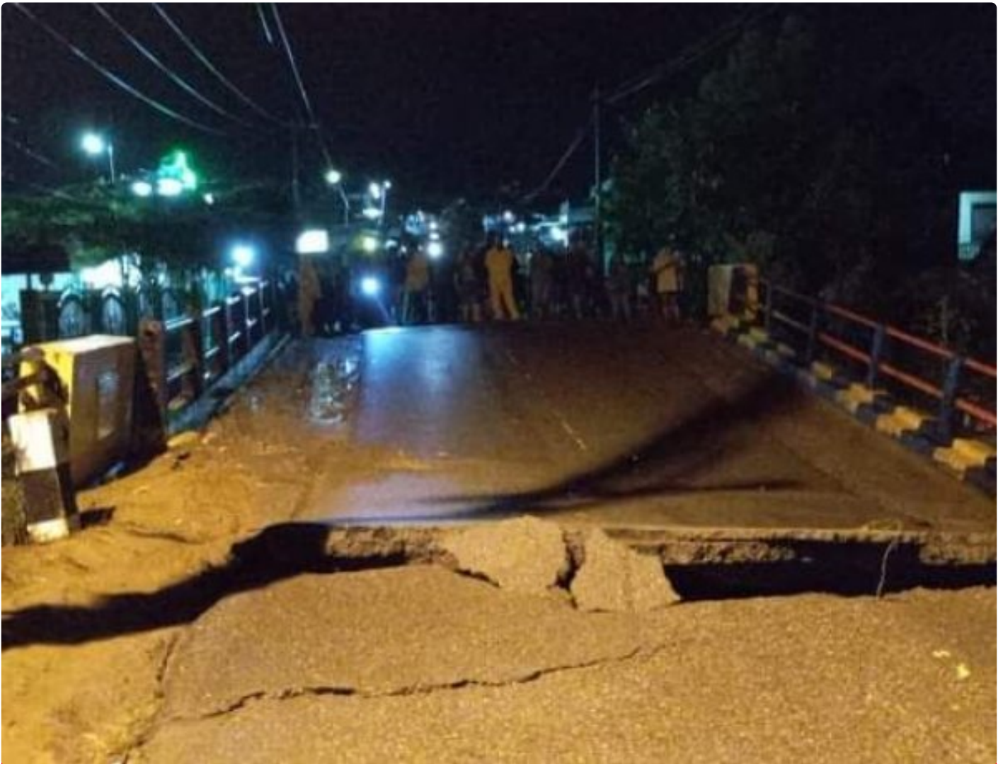
Jembatan Tamiai, kecamatan Batang Merangin, Kabupaten Kerinci ambruk, Senin malam (01/01/2024).
