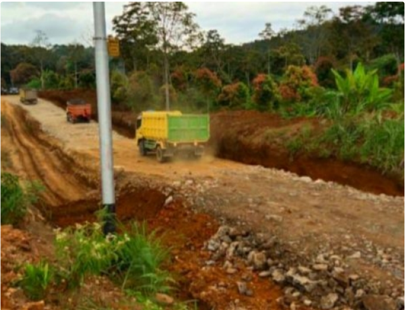
Kondisi Jalan Pungut Mudik - Sungai Kuning kabupaten Kerinci terkini, foto: ist
